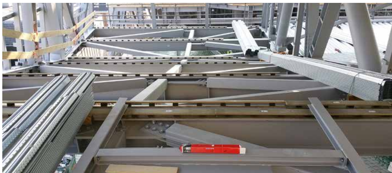
Tussen de vloer en de kolommen zijn aardbevingsbestendige en akoestische oplettingen van Vilton geplaatst, met daarin een zacht deel dat geluidstrillingen isoleert en een stijver deel dat zorgt voor de belastingoverdracht tijdens een aardbeving.
